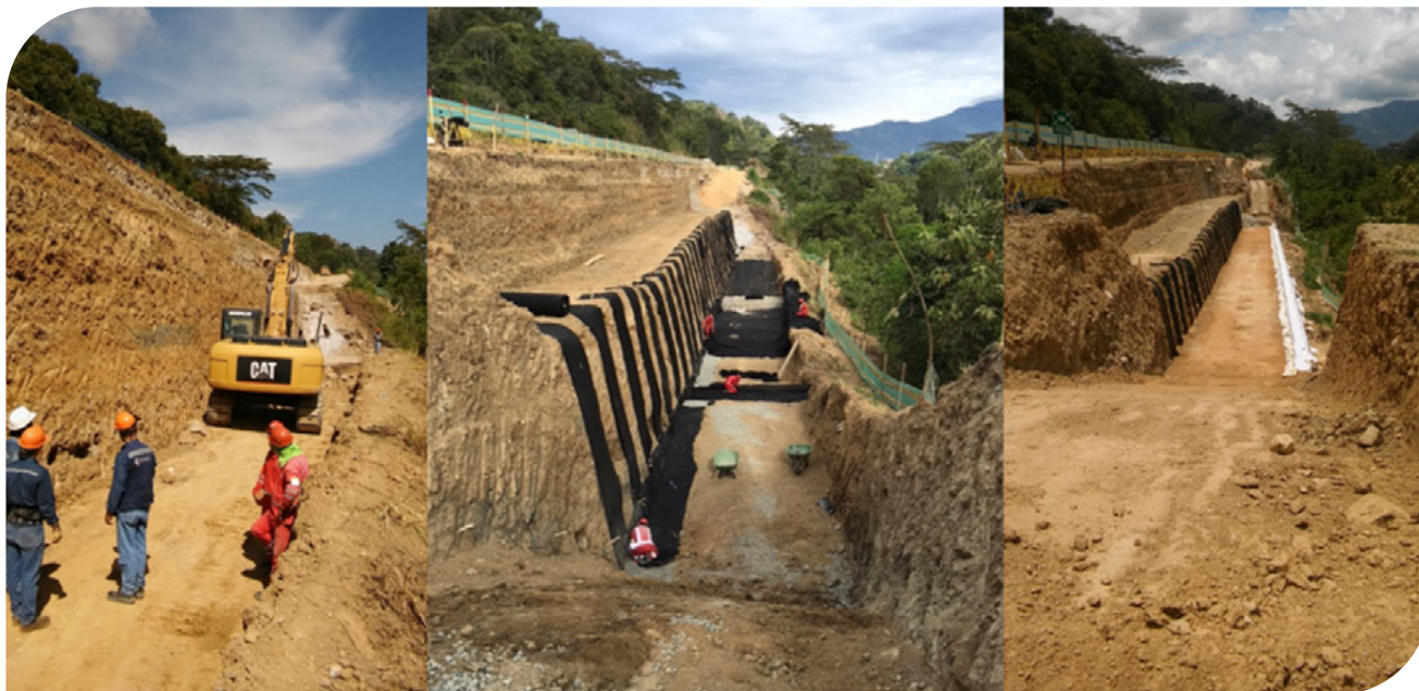
▲ Fotografia 11.2 | Projeto e construção de muro em solo reforçado, APP GICA, Ibagué-Tolima-Colômbia.
