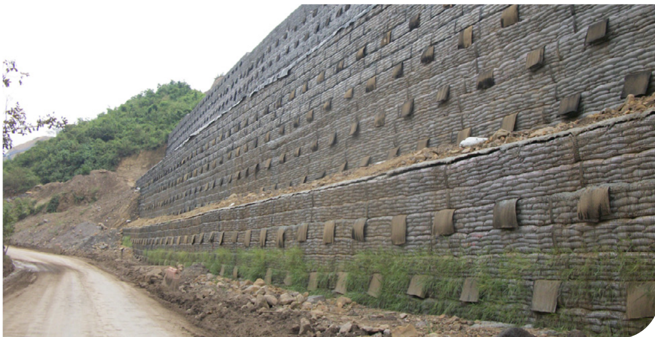
▲ Muro de solo reforçado com Geogrelha Uniaxial | Via Ruta del Sol, setor 1 km 57, Colômbia.
