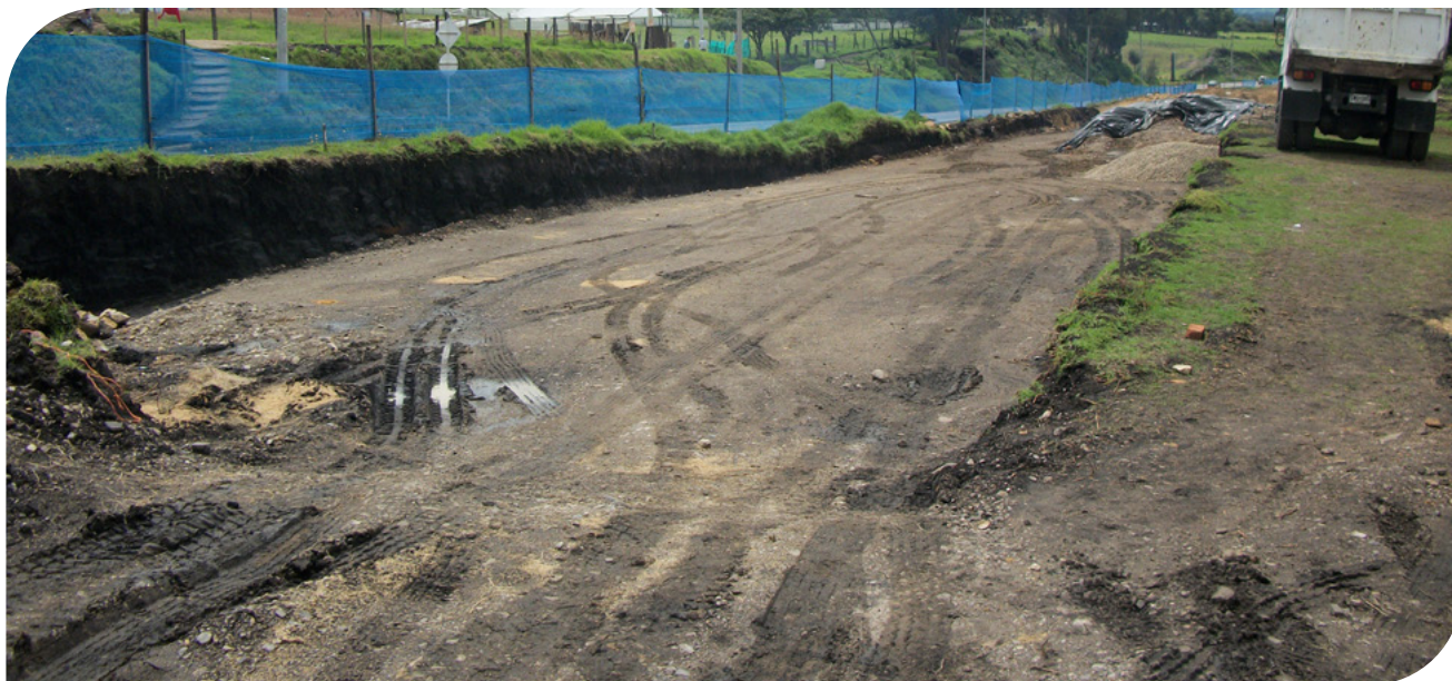
▲ Figura 4.10 | Subleito mole para a construção de estrutura de pavimento.
