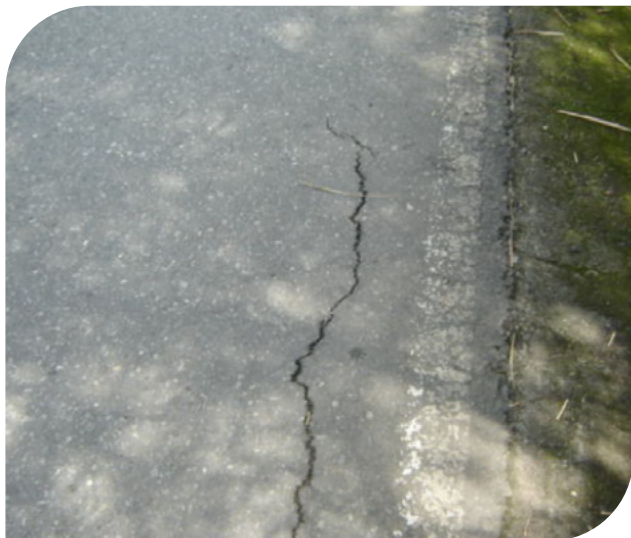
▲ Imagem 8.9 | Trinca de borda.
