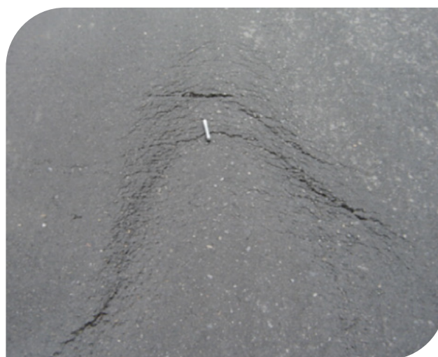
Imagem 8.8 | Formação de trincas por escorregamento de camadas. 3
