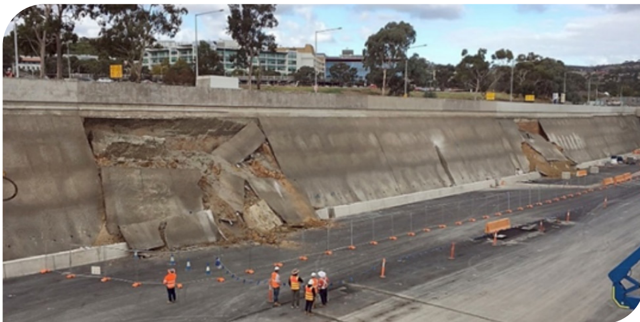
▲ Fotografia 16.11 | Falha na proteção com concreto projetado. Foto de Tony Lewis.
