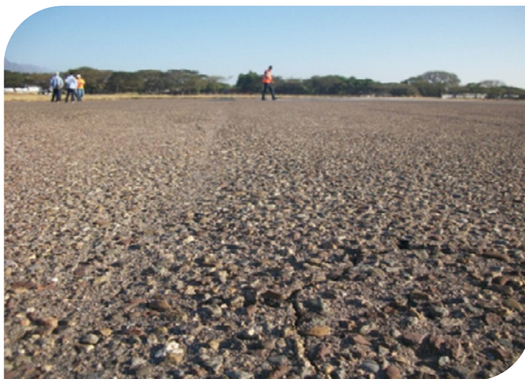
▲ Imagem 8.23 | Cobertura de rolamento envelhecida, oxidada, trincado com presença de cabeças duras, o que requer uma camada prévia de nivelamento para melhor aderência de uma Geogrelha de Fibra de Vidro.
