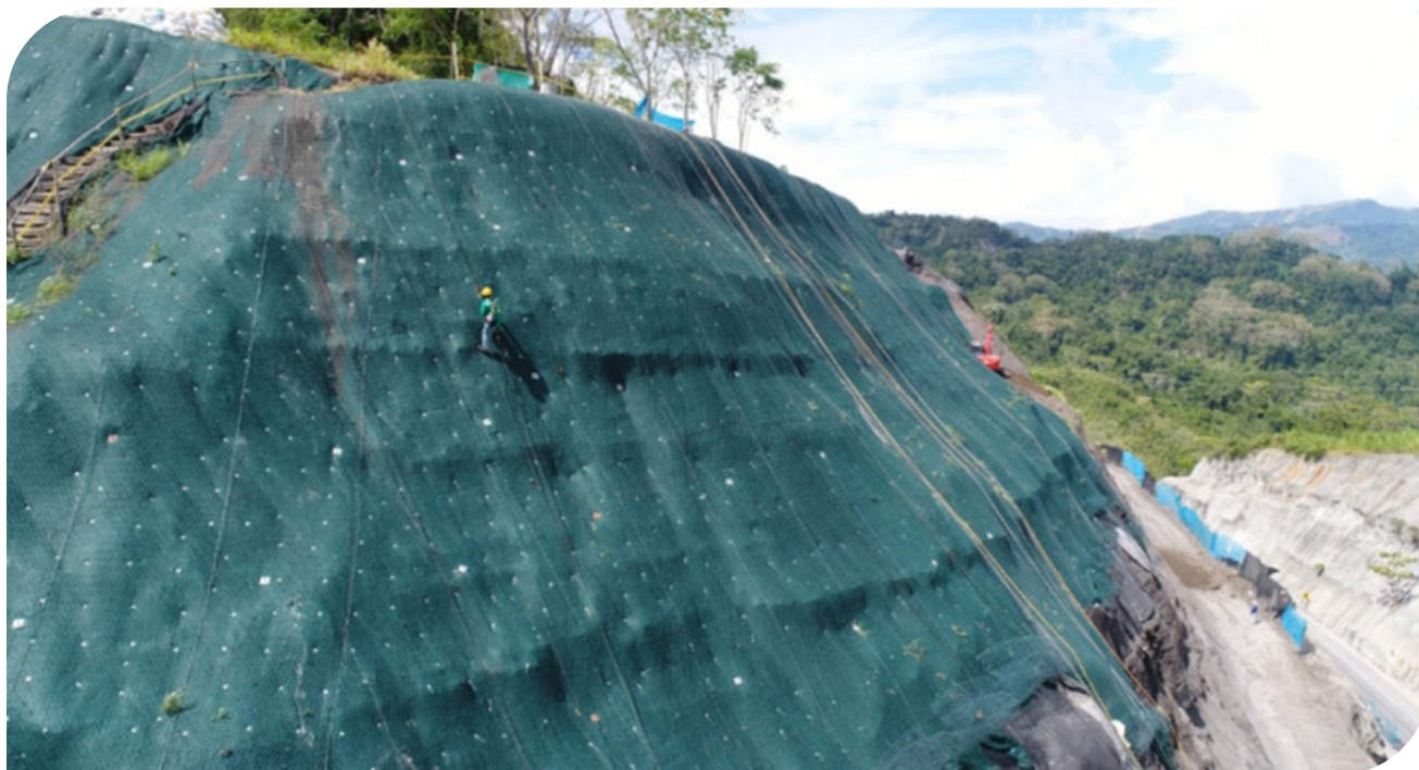
▲ Fotografia 16.8 | G-Green: Manto - chumbadores. Perfil com erosão diferencial.
