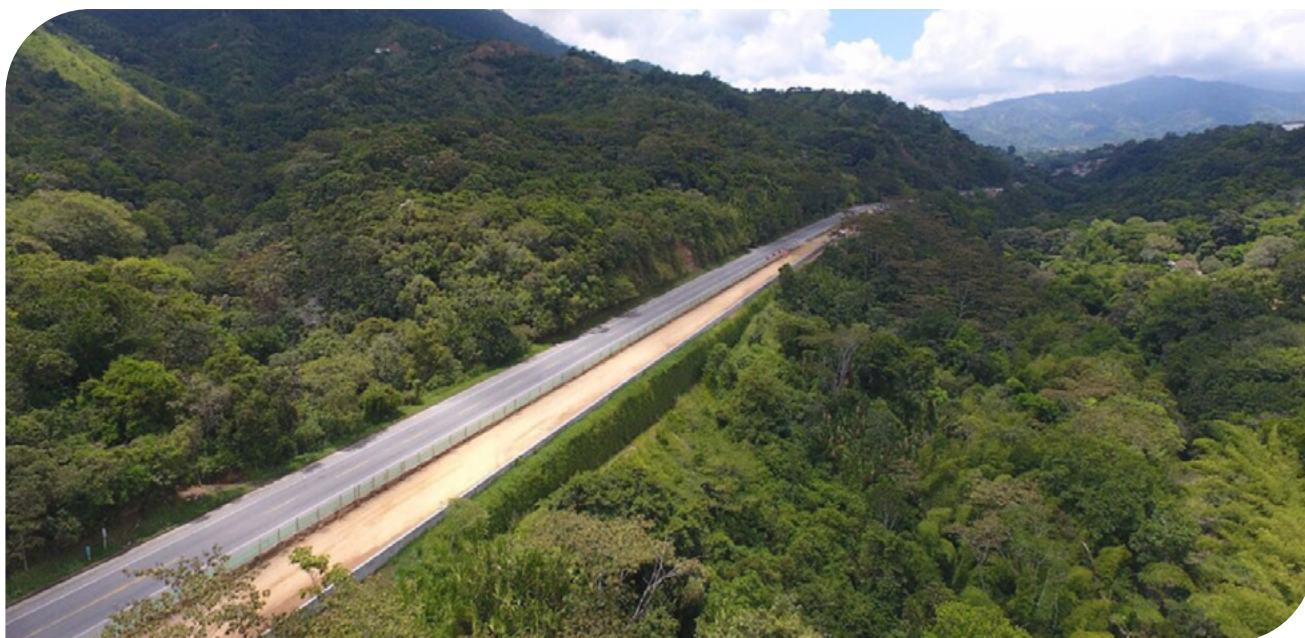
▲ Fotografia 11.3 | Projeto e construção de muro em solo reforçado, APP GICA, Ibagué-Tolima-Colômbia
