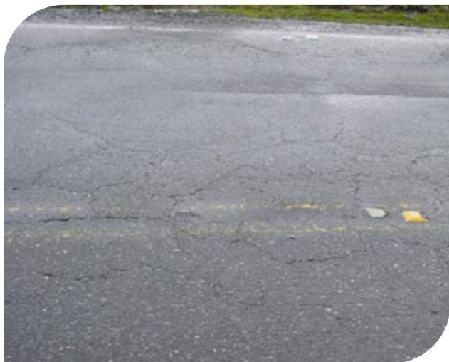
▲ Imagem 8.5 | Trincas em bloco. 3
