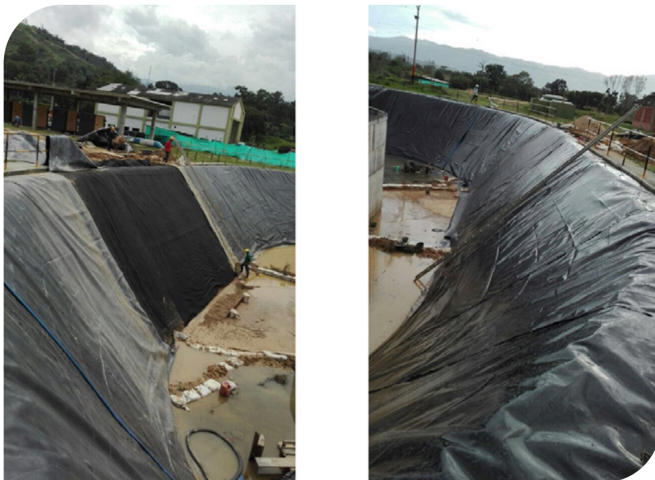
▲ Planta de tratamento de águas residuais | Floridablanca – Santander 2017.
