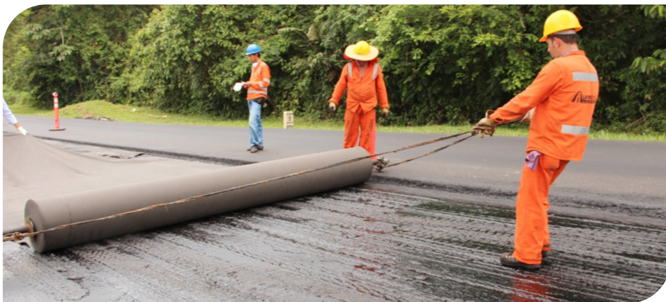
▲ Repavimentação com Geotêxtil Não Tecido REPAV | Autoestradas de los Llanos, Villavicencio, Colômbia.
