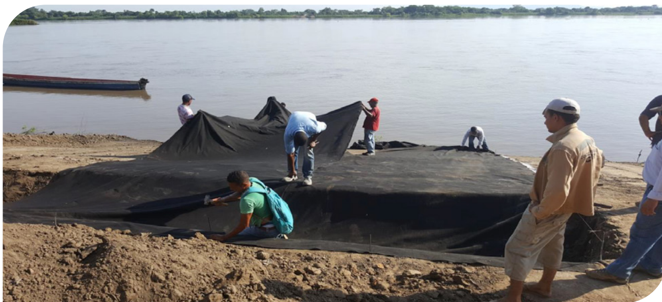
▲ Fotografia 17.39 | Colocação de Geotêxtil Não Tecido - projeto Tamalameque, departamento de Cesar, Colômbia.
