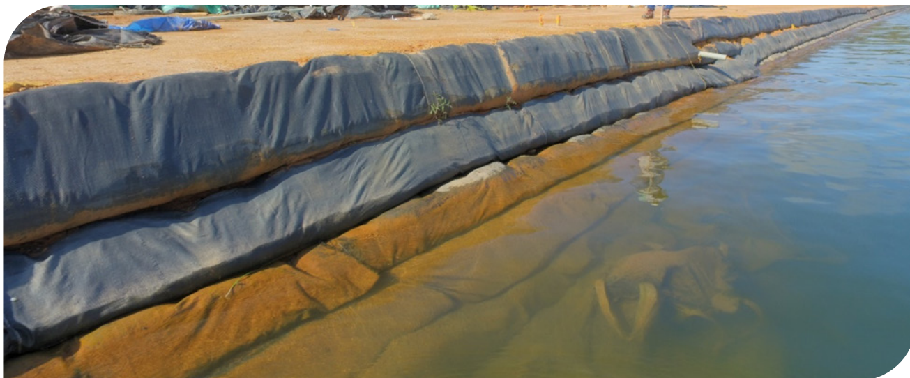
▲ Fotografia 17.57 | Conformação de corpo sobre estrutura de fundação no sistema Geoland cais turístico Guatapé.
