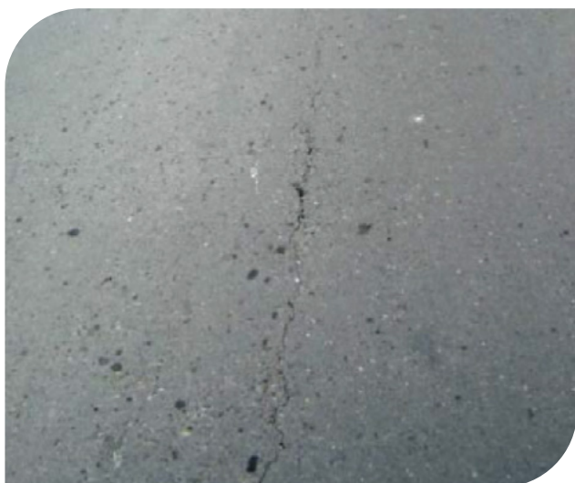
▲ Imagem 8.3 | Trinca Longitudinal. 2
