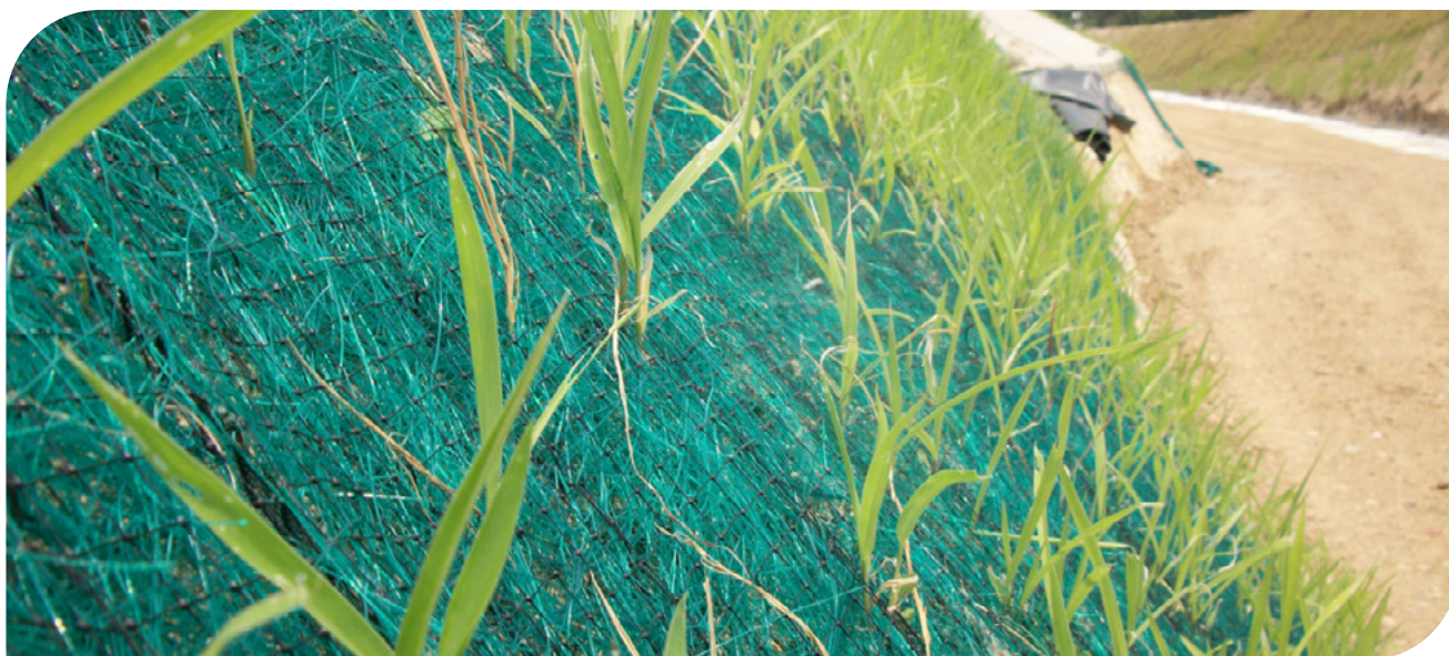
▲ Revegetação de talude com manto permanente TRM | Via Ruta del Sol, setor 2 km 75, Colômbia.
