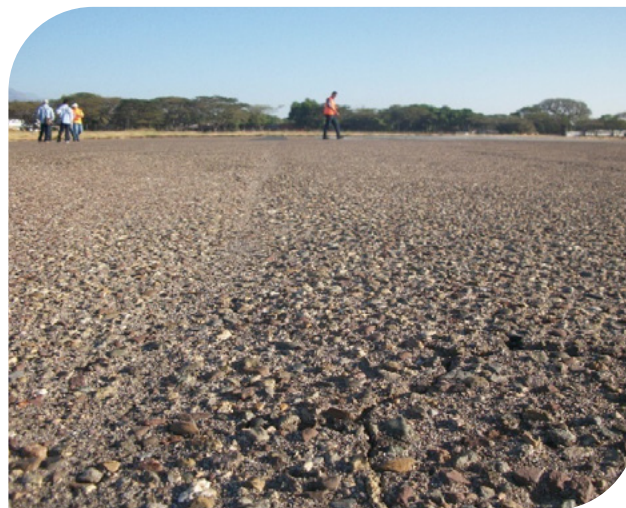
▲ Imagem 8.6 | Desagregação com trincas.
