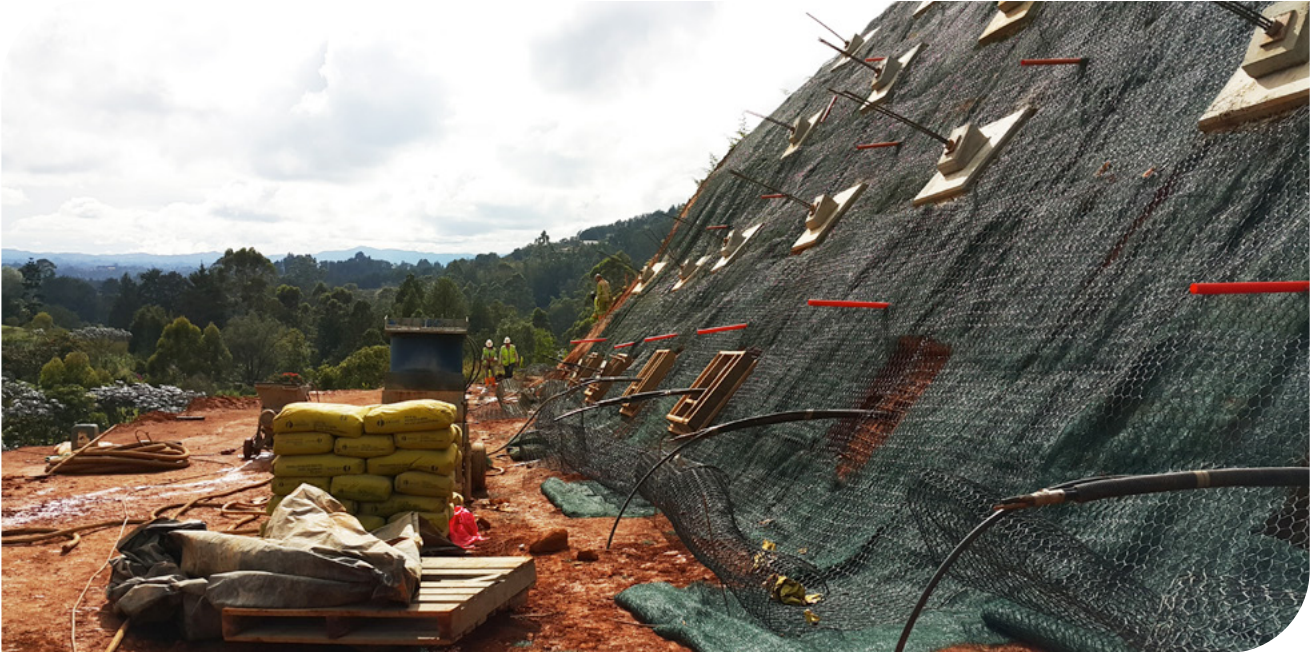
▲ Fotografia 16.12 | Instalação G-Green túnel oriental.
