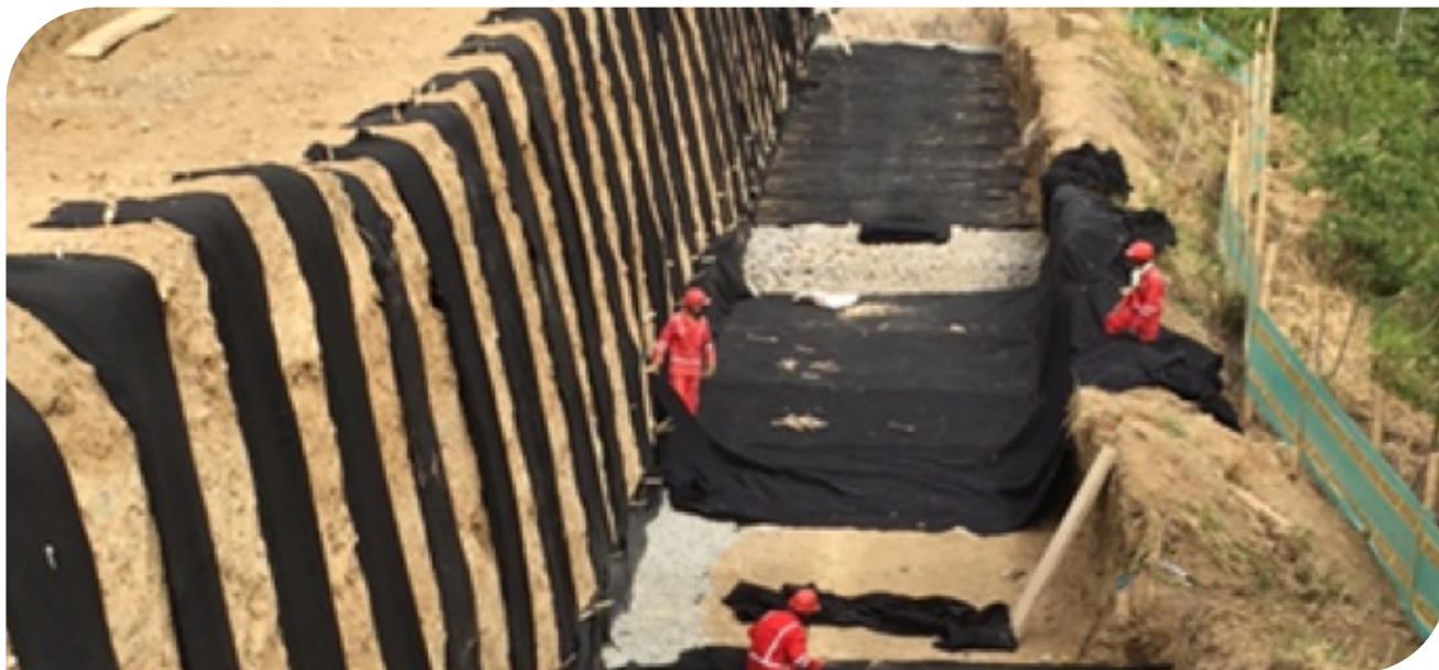
▲ Fotografia 11.7 | Construção de colchão de dreno e filtro em encosta, muro em solo reforçado ALMA.
