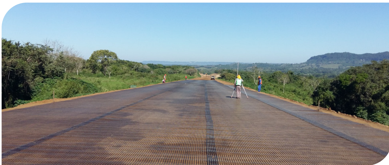
▲ Reforço de estrutura viária com Geogrelha Biaxial Extrudada | Rodovia Cardel - Poza Rica - Seção Laguna Verde, Veracruz, México
