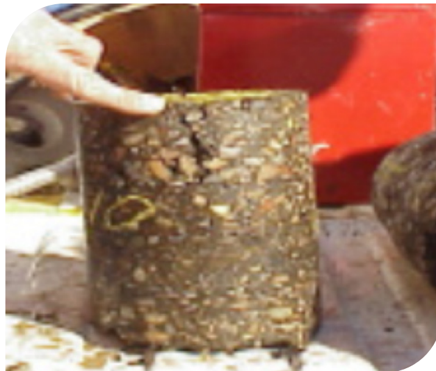
▲ Imagen 8.14 | Núcleo con top-down cracking.
