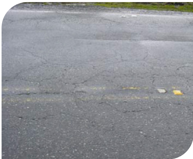
▲ Imagen 8.5 | Fisuras en bloque. 3
