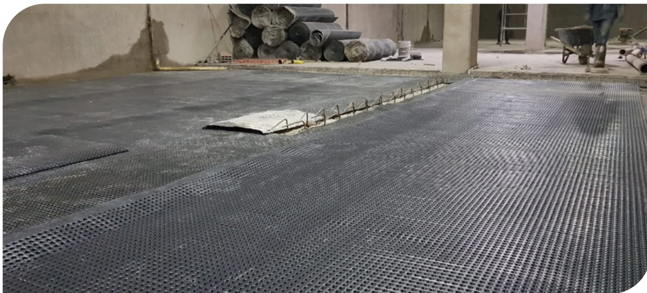
▲ Sistema de drenaje en cimentaciones con TecDren | Edificio Sigma, Bogotá, Colombia.
