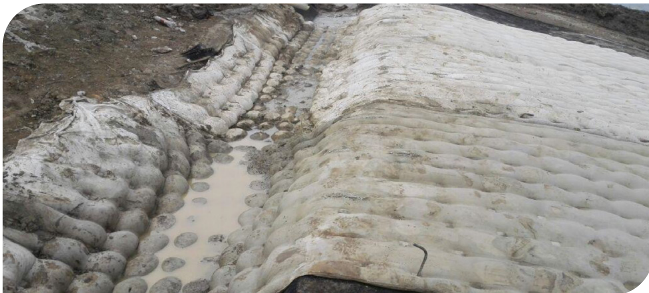
▲ Fotografía 17.42 | Llenado de la trinchera de anclaje, proyecto Tamalameque, departamento de Cesar, Colombia.
