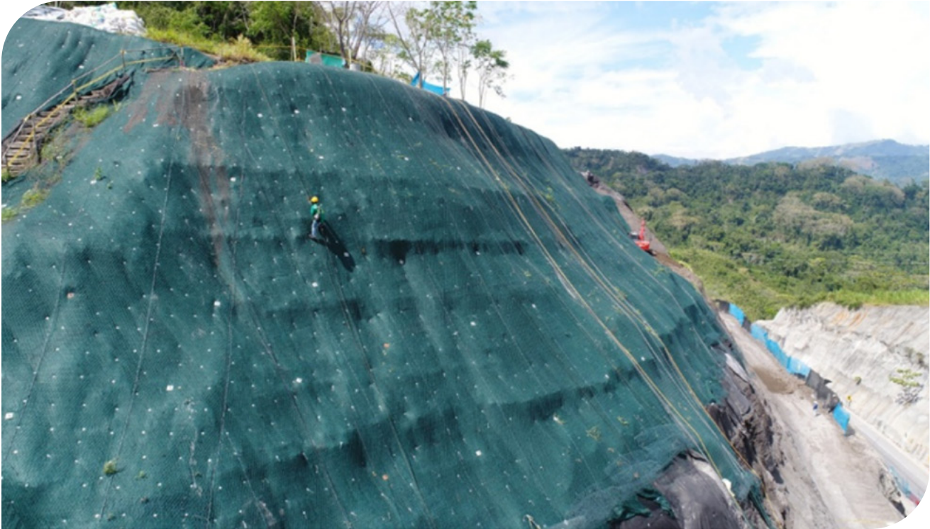
▲ Fotografía 16.8 | G-Green: Manto – malla talud. Perfil con erosión diferencial.
