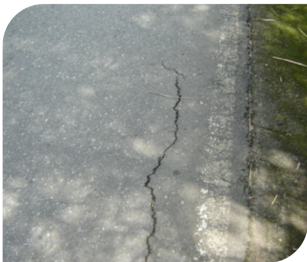
▲ Imagen 8.9 | Fisura de borde.
