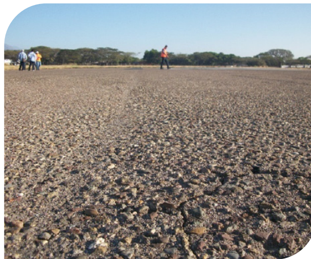
▲ Imagen 8.6 | Cabezas duras con fisuras.
