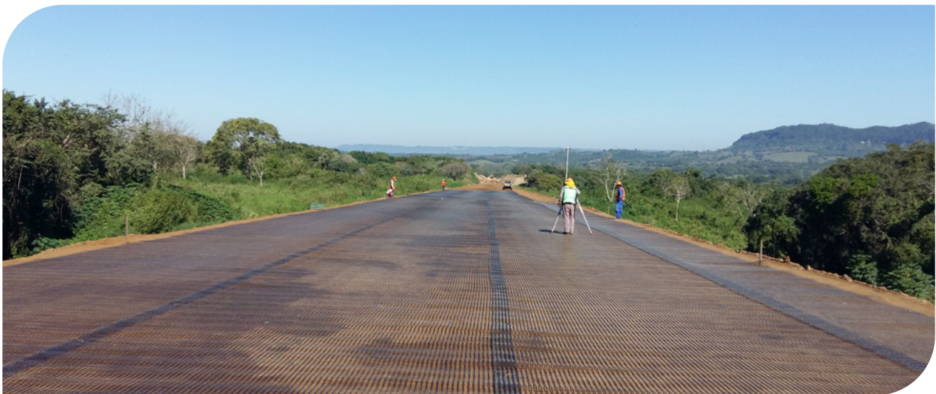
▲ Refuerzo de estructura de carretera con Geomalla Biaxial Coextruida | Autopista Cardel - Poza Rica - Tramo Laguna Verde, Veracruz, México.
