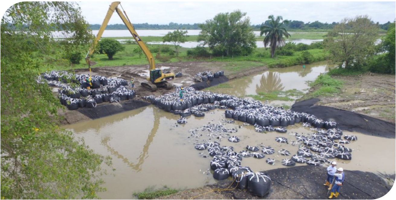
▲ Fotografía 17.56 | Construcción de Dique mediante tecnología Geoland en la Ciénaga el Llanito Barrancabermeja - Santander Colombia, construido por el consorcio Obras San Silvestre.
