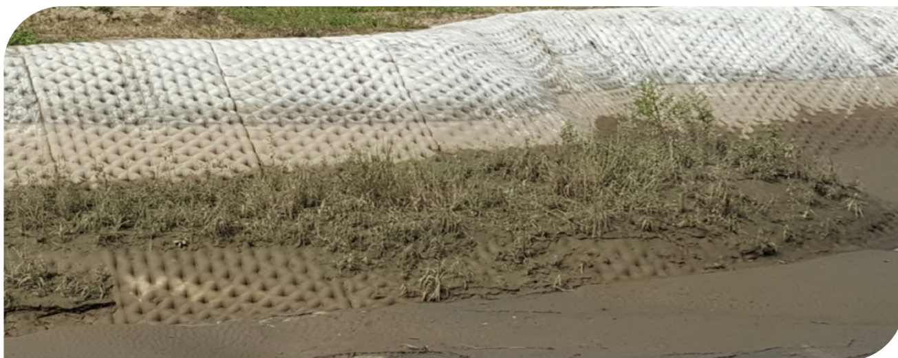
▲ Fotografía 17.43 | Algas y vegetación creciendo sobre el Flexocreto.
