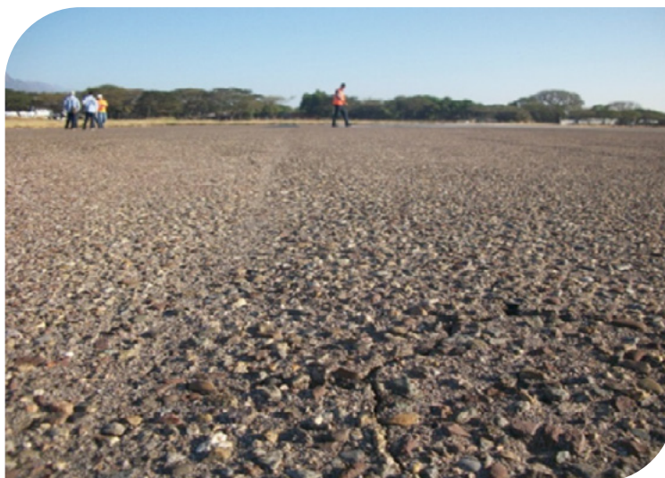
▲ Imagen 8.23 | Capa de rodadura envejecida, oxidada, agrietada con presencia de cabezas duras, que requiere capa de nivelación previa para lograr mejor adherencia de una Geomalla de Fibra de Vidrio.
