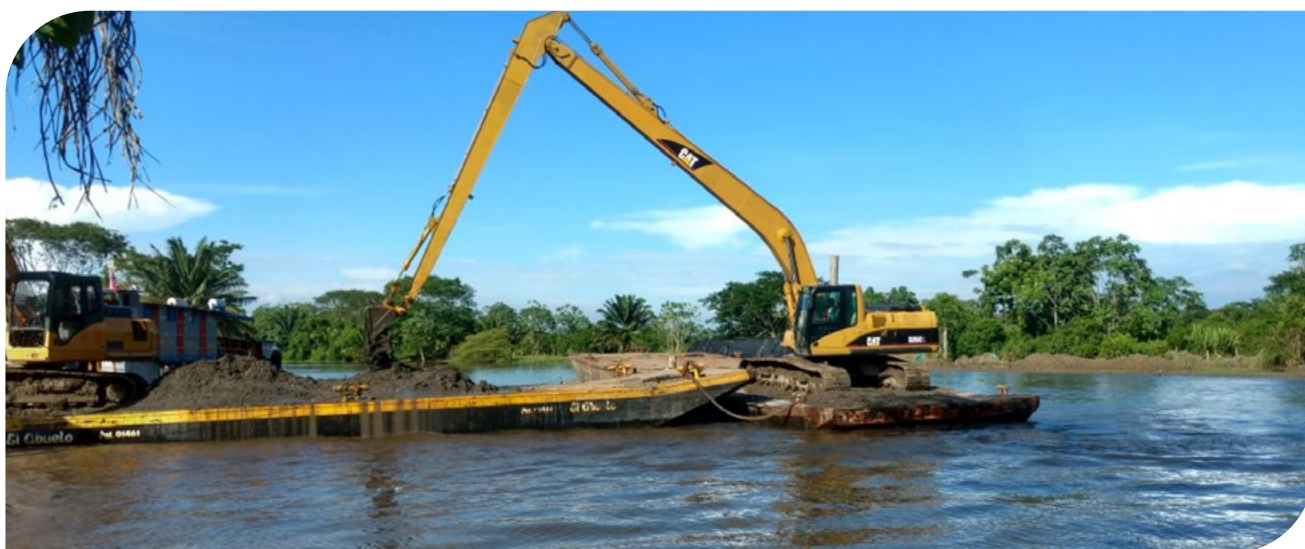
▲ Fotografía 17.58 | Excavación y adecuación del terreno bajo agua para la instalación de Geobags Estructura hidráulica San Silvestre Barrancabermeja - Santander Colombia, tomada del Consorcio Obras San Silvestre.
