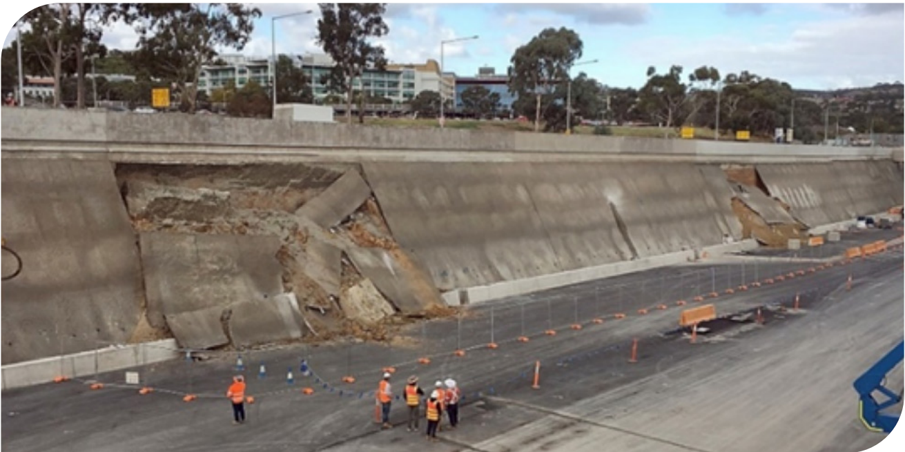
▲ Fotografía 16.11 | Falla en protección con concreto lanzado. Foto de Tony Lewis.
