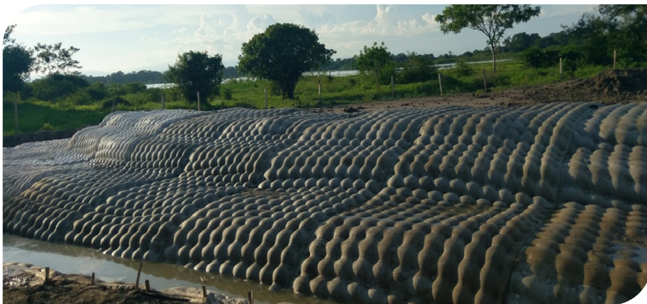
▲ Fotografía 17.61 | Recubrimiento mediante Flexocreto 10000 en Caño Cocos Ciénaga el Llanito Barrancabermeja Santander – Colombia.
