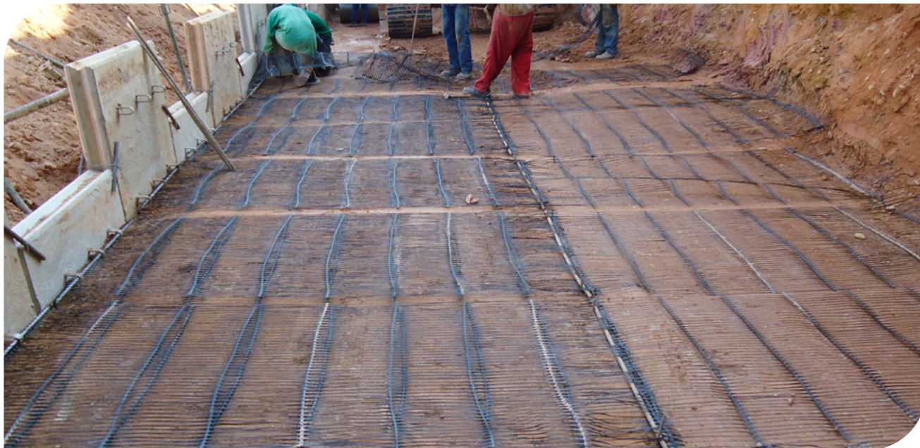
▲ Fotografía 11.10 | Fachada en paneles en escamas de concreto, como estructura pegada al muro en suelo reforzado con Geomalla.
