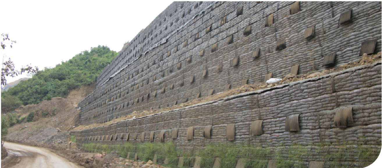
▲ Muro en Suelo Reforzado con Geomalla Uniaxial | Vía Ruta del Sol Sector 1 Km 57, Colombia.
